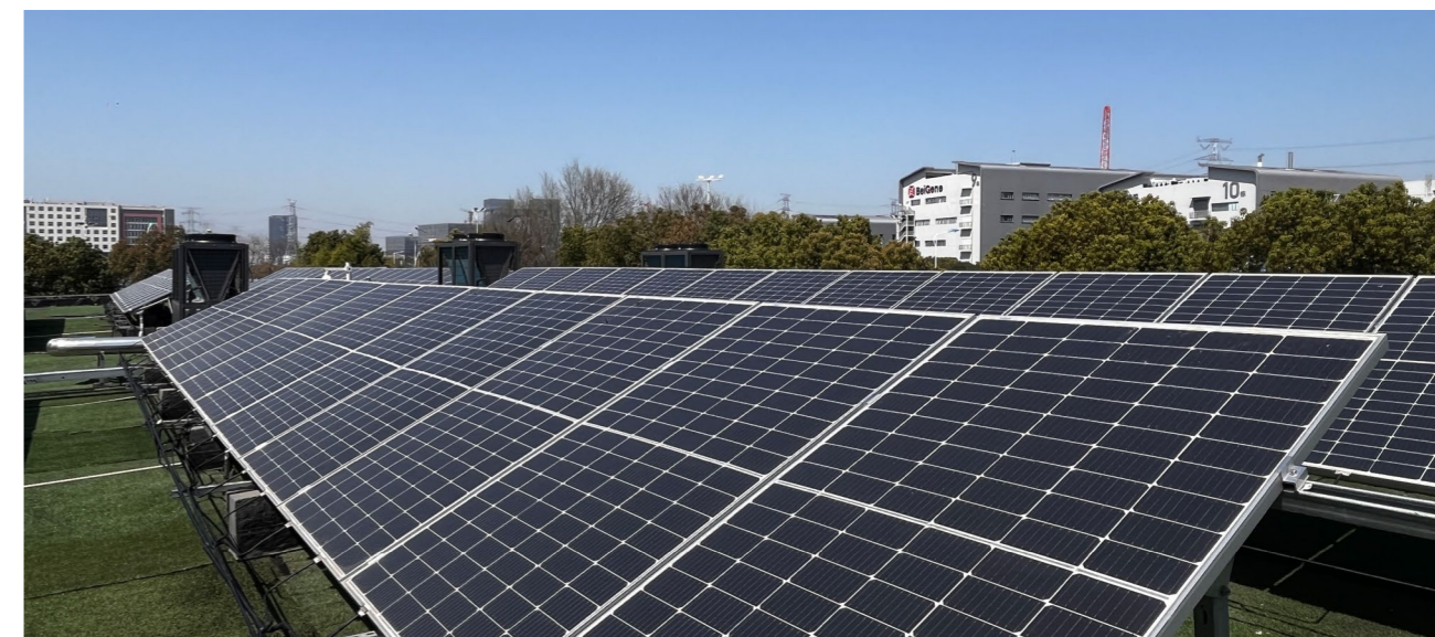
协鑫书院（餐厅）采用光伏光热热泵系统（PVT）
